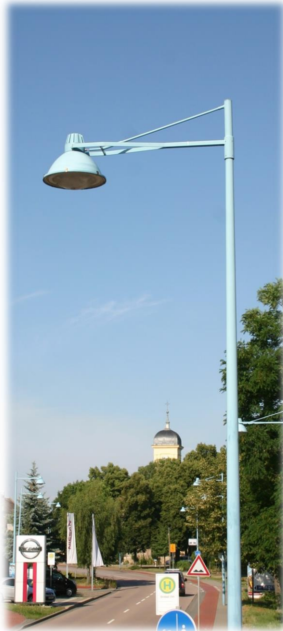
Abb. 55: Toronto 630 mit Mast
