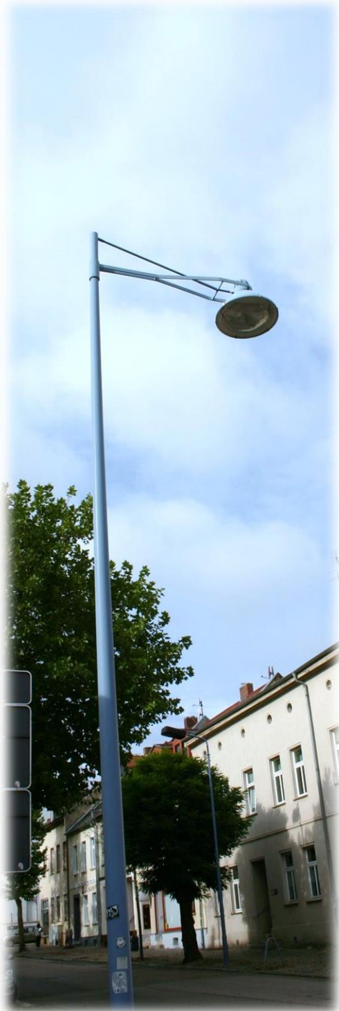
Abb. 53: Toronto 480 mit Mast
