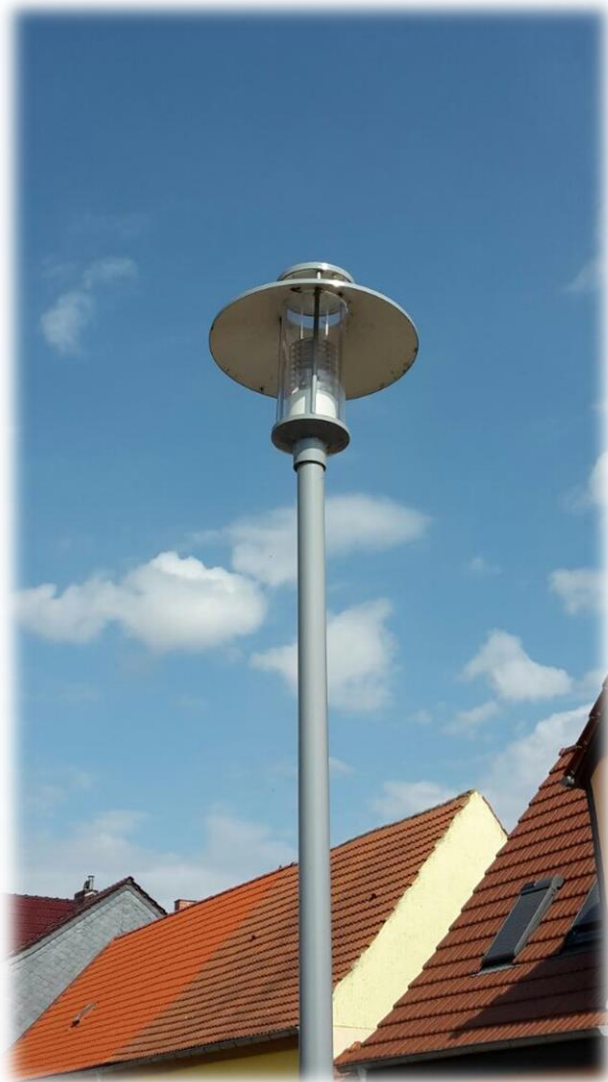
Abb. 36: Mast mit Leuchte (NA-Variante)
