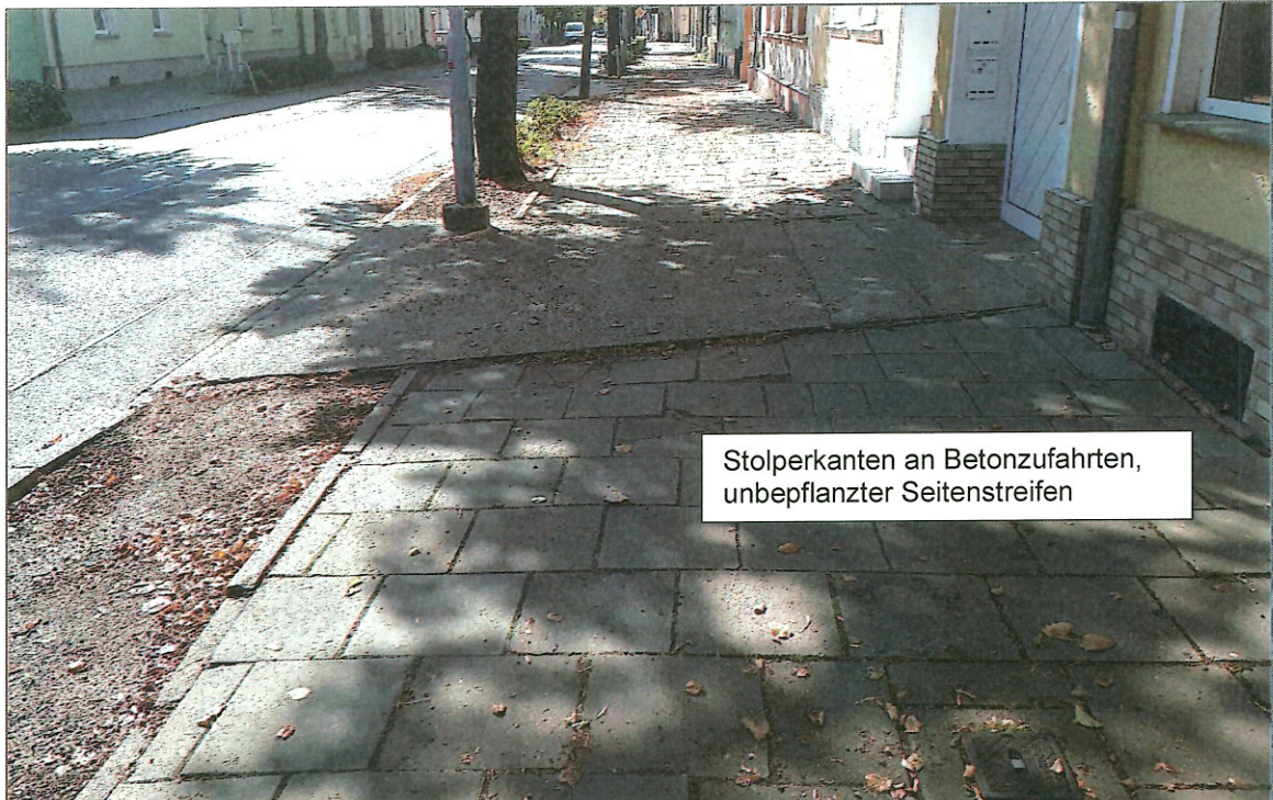
Gehweg im Bereich zwischen Siftstraße und Christianstraße
