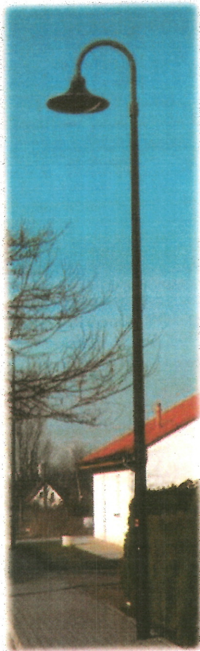
Abb. 27: Leuchte 9301 mit Mast
