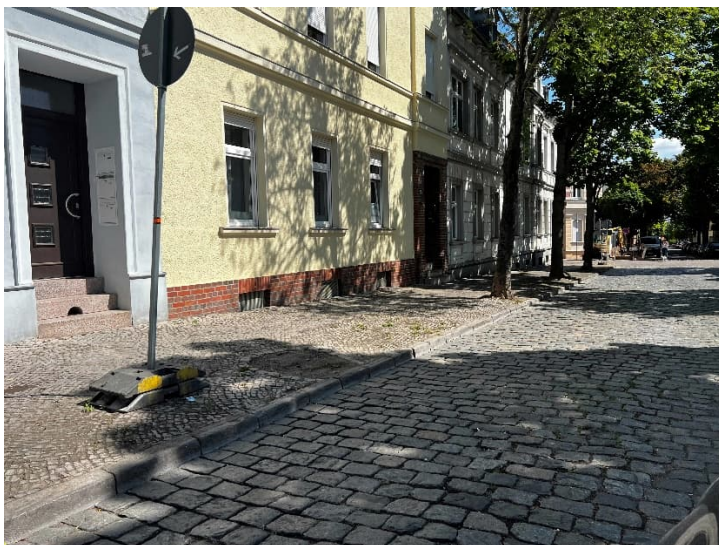
Unebenheiten und Verwerfungen im Pflaster
