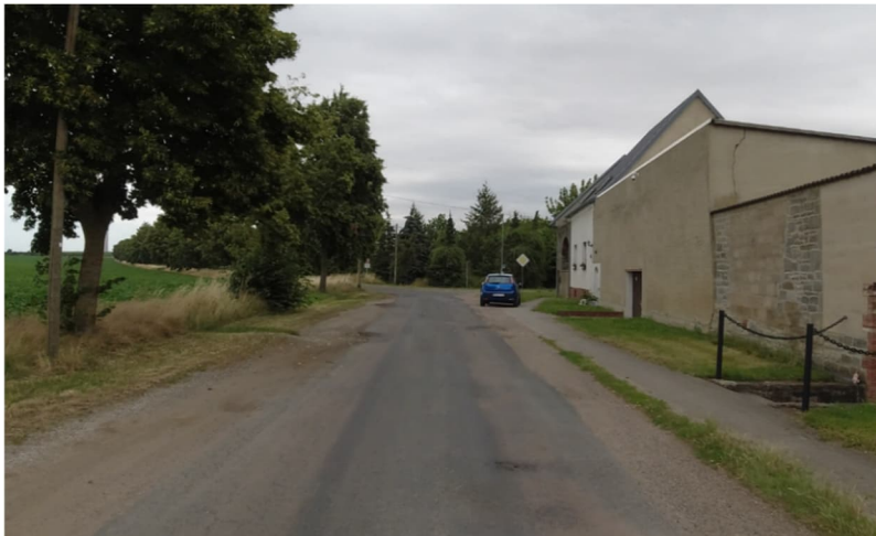
Abgebrochene Ränder und Ausspülungen in den Randbereichen
