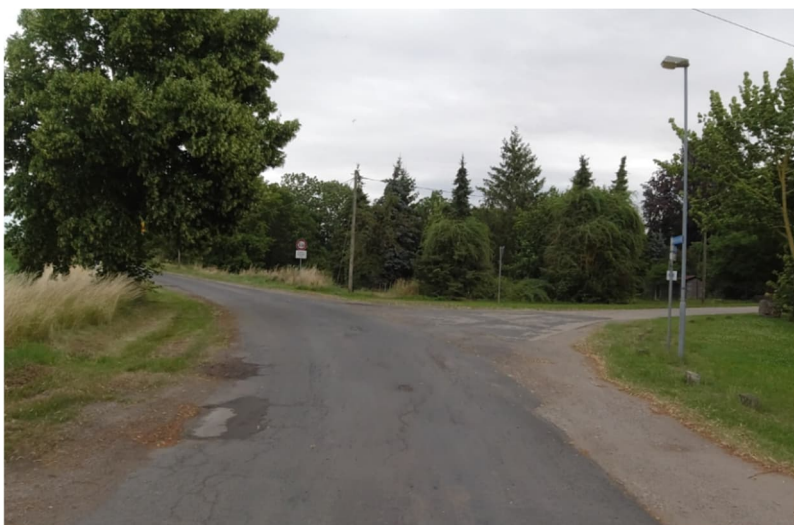
Fahrbahnschäden im Kurven-/Einmündungsbereich „An der Mühle“
