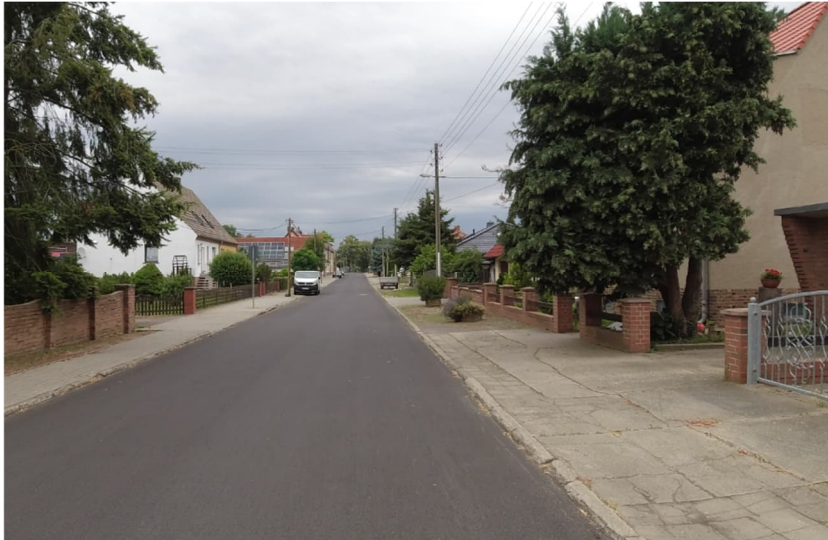
Baalberger Straße 2. BA Gehweg Ostseite – Betonflächen, unbefestigte Flächen, Setzungen längs
