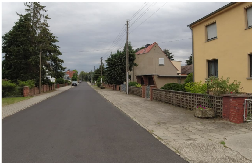
Baalberger Straße 2. BA, Gehweg Ostseite (links) mit diversen Materialien und Setzungen längs
